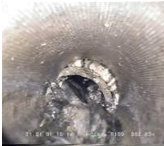
Засор канализационного коллектора
